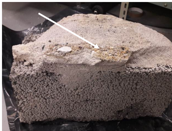
Kuva 18. Vuonna 2015 korjauksessa lisätyn Leca-harkon alapuolelta otettiin materiaalinäyte. Näyte otettiin orgaanisesta materiaalista (nuoli). Leca harkon alla oli voimakas mikrobiperäinen haju. Leca hakko on honeesta 4. Materiaalinäytteessä oli vahva viite vauriosta.
