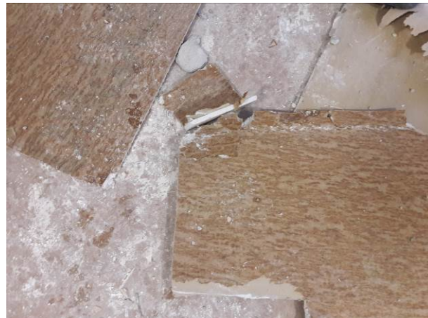
Kuva 10. Huone 4. Alkuperäinen tuulensuojalevy esillä olevalta noin 0,5-1,5 m korkeudelta oli kauttaaltaan kosteusjälkien peittämä.
