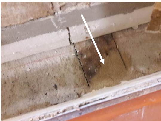
Kuva 23. Huone 3/4. Väliseinän alaosan valussa oli puuta (nuoli). Puuta on vaikea poistaa kokonaan koska sitä ulottuu myös lattian alle. Puut poistetaan näkyvältä osalta.
