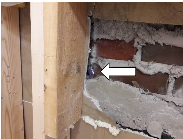
Kuva 15. Huone 04. Halkaisijaltaan 5 cm kokoinen reikä julkisivumuurauksessa.
