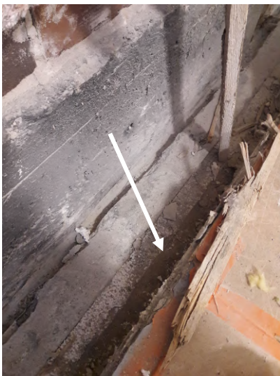
Kuva 21. Huone 10. Ulkoseinän alaosa purun jälkeen. Maaperästä on ollut ilmayhteys seinärakenteeseen, nuoli osoittaa leveää rakoa maata.
