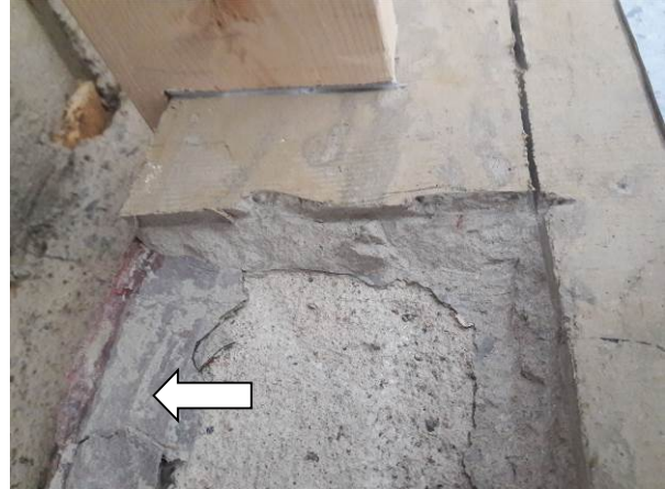
Bild 30. Huone 10. Ulkoseinän kohdalla sulkukäsittelyn ja tasoitteen välissä on jonkinlaista tiivistys- tai eristysmassaa (nuoli). Tasoitekerros on todella paksu, noin 15-20 mm.
