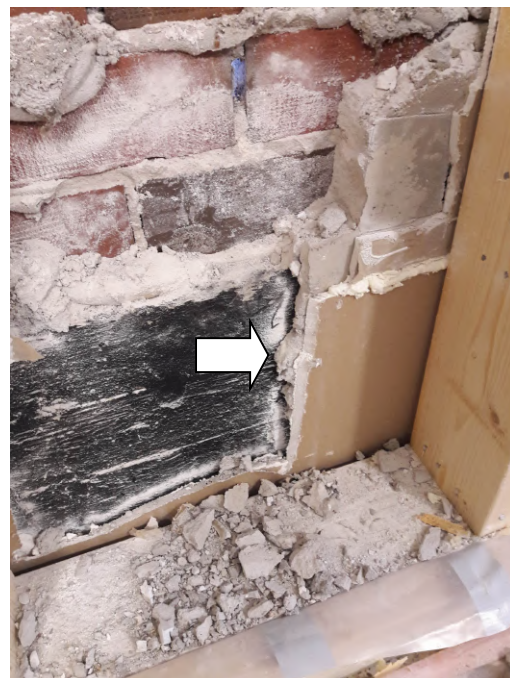
Kuva 12. Huone 4. Laasti on tunkeutunut sokkelin ja tuulensuojalevyn väliin. Märkä laasti ei ole päässyt kuivumaan ulospäin, ainoastaan sisään, ja osaltaan aiheuttanut hyvin kosteat olosuhteet alaseinän rakenteisiin. Tässä 21 cm piilosokkelin alaosa maan pinnan alapuolella.
