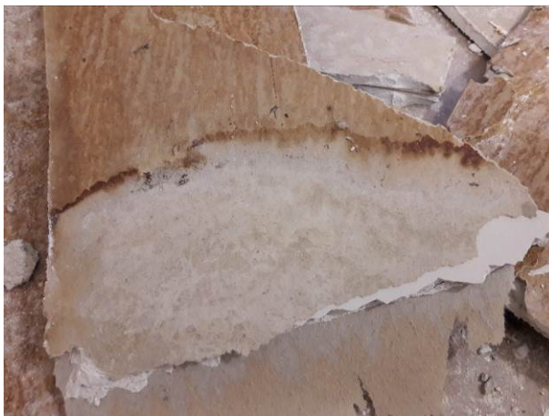
Kuva 13. Huone 4. Kosteusjäljet pysähtyvät siihen kohtaan, jossa levy on ollut laastikasaumaa vasten.
