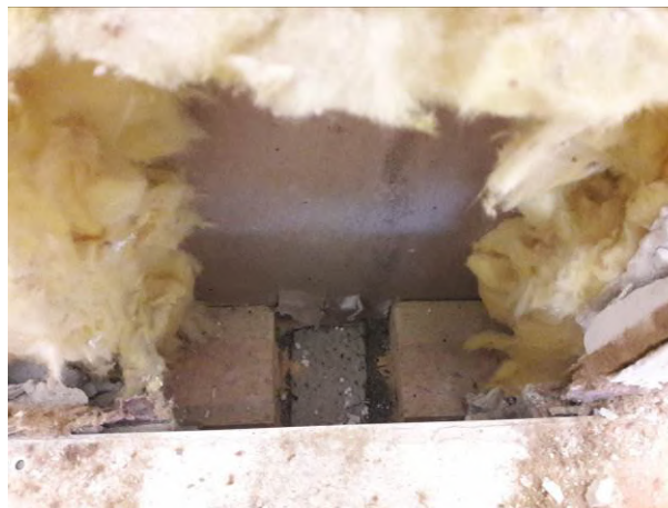
Kuva 16. Huone 4. Väliseinän alaosa avattuna. Tutkimuksessa v. 2018 todettiin että eriste alajuoksun päältä on mikrobivaurioitunut
