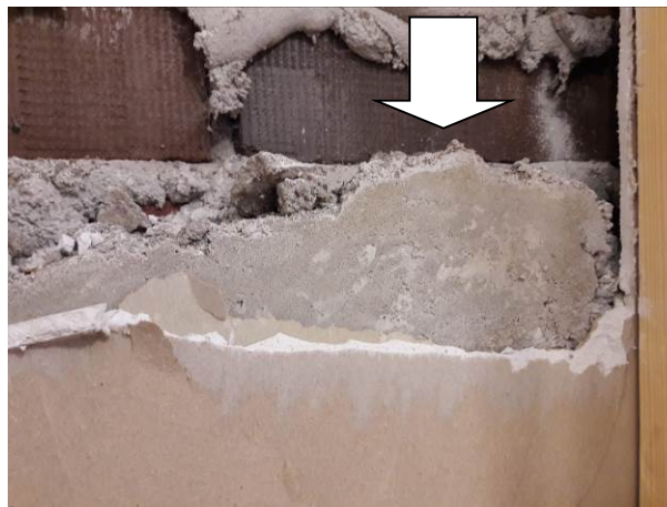
Kuva 14. Huone 4. Vasemmanpuoleinen levy pala irrotettu tästä.
