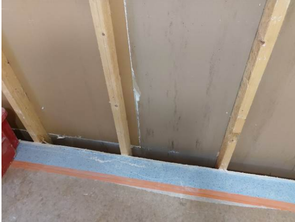
Kuva 29. Huoneiden 11/9 väliseinä (huoneen 11 puolelta katsottuna). Tähän on joskus vaihdettu levy paikkaamalla. Toisella puolella on huone 09 (WC).
