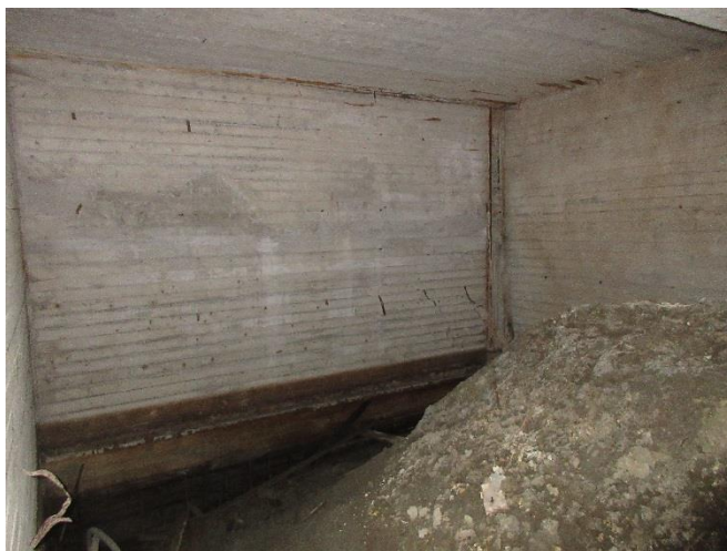
Bild 23. Utgångsläge. I krypgrunden fanns vatten och gammalt formverk.
